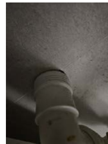
Utett rørgjennomføring i vegg under servant
