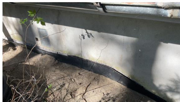
Topplst mangler på enkelte steder.
