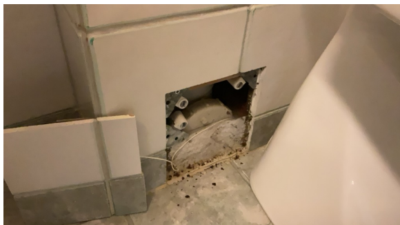
Stakeluke bak flis på bad i underetasje.
