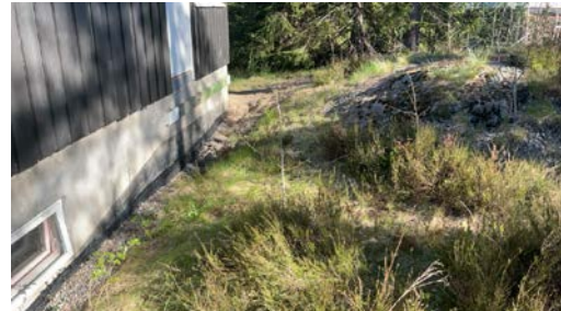
Terrenget faller stedvis inn mot bygningen og det skaper forhold for vann inn mot muren.
