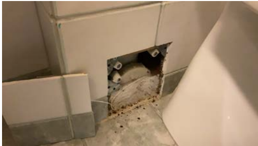
Stakeluke bak flis på bad i underetasje.
