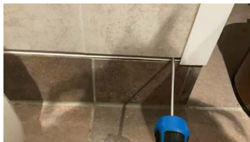
Mangler fuge i bunn av våtromsplater.
