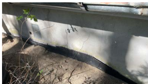
Topplst mangler på enkelte steder.
