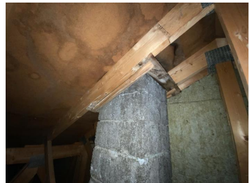
Kontroll rundt pipeløp. Noe missfarget undertak.
