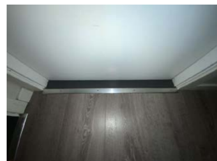
Toalettrom mangler tilluftsventilering, f.eks. spalte/ventil ved dør.
