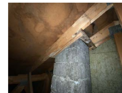
Kontroll rundt pipeløp. Noe missfarget undertak.
