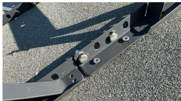
Feil skruer er brukt på takstige.
