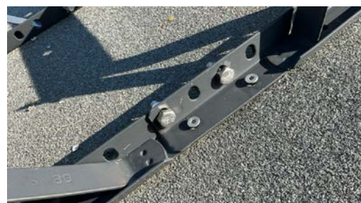
Feil skruer er brukt på takstige.
