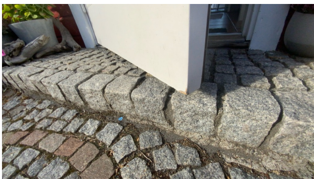
Noe skader på inngangsdør.
