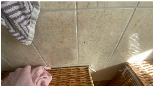
Hull i vegg etter tidligere montasje.
