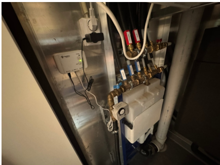
Rørinstallasjonen er ikke sprutsikret.
