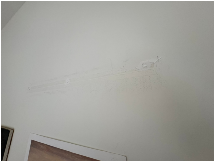
Eksempel på hakk og merker i veggoverflaten.
