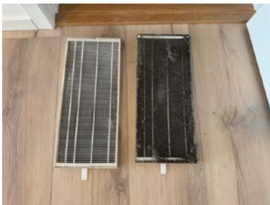
Filterene til ventilasjonsanlegget.
