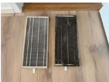
Filterene til ventilasjonsanlegget.
