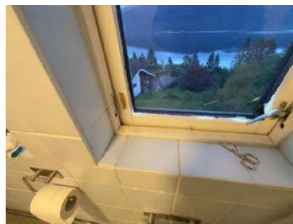
Det mangler en haspe på et vindu.
