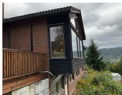
Det mangler vindduk på felt under stuevindu mot sør. Dette ble oppdaget i forbindelse med reklamasjon etter at nåværende eier overtok boligen. Det bør gjøres ytterligere undersøkelser av veggkonstruksjonen for å få oversikt over utførelsen av øvrige felt med bindingsverk og trekledning.
