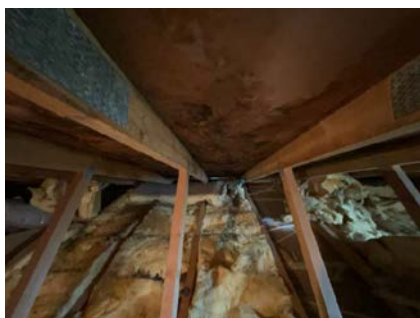
Skjolder etter fukt på undertaket. Dette var tørt på befaringdagen.
