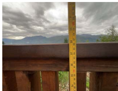
Høyde på rekkverk ble målt til 96 cm. Gjeldende krav er 100 cm.
