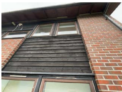
Felt med trekledning mangler luftespalte i nede kant, samt at nederste del av krabbelist på høyre side er knekt.
