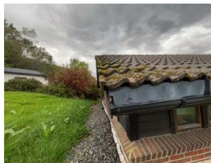
Skjevheter i takutstikk på garasje.
