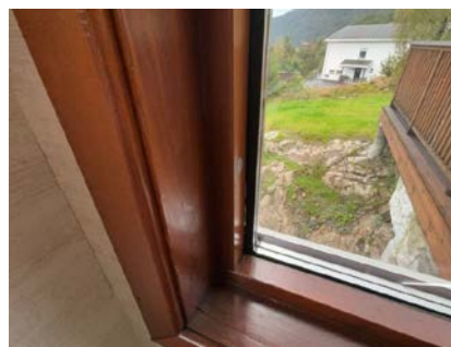
Glass i vindu mot sør i stuen er ut av posisjon og glasset har sprukket.
