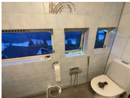
Vinduer på bad i hovedetasjen er vanskelige å åpne/lukke.
