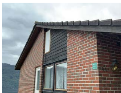
Skjevheter i takutstikk.
