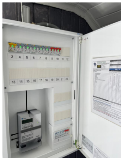
Sikringskapp plassert på vegg trappegang 2.etg.
