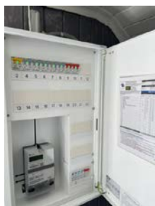
Sikringsskap plassert på vegg trappegang 2.etg.
