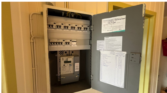
Sikringsskapet er plassert i gangen
