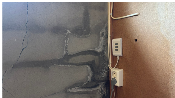
Saltutslag på boden
