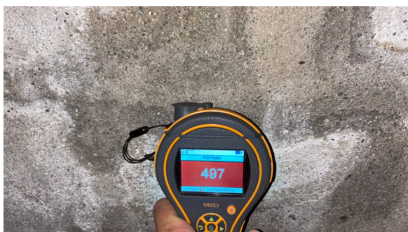
Utslag på forhøyde fuktverdier
