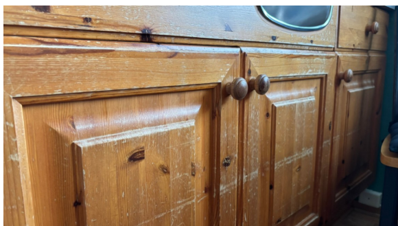
Stedvis større slitasje på skapfrontene
