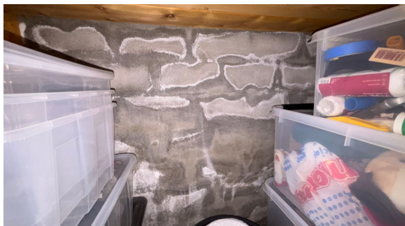
Saltutslag på boden
