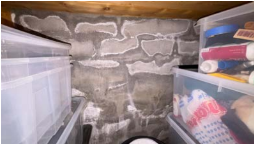
Saltutslag på boden
