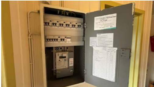
Sikringsskapet er plassert i gangen
