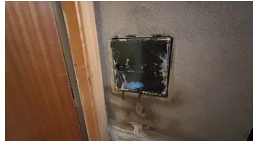
Avstand til brennbart materiale er for lite
