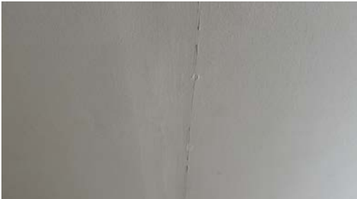
Sprekkdannelse i himlingen i stuen
