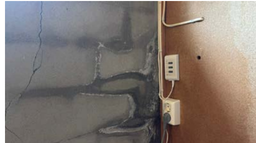
Saltutslag på boden
