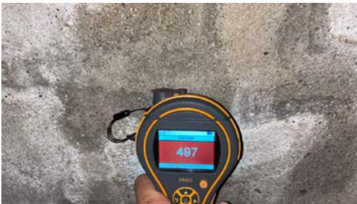
Utslag på forhøyde fuktverdier
