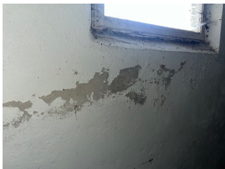
Eksempel på avskaling på vegg.
