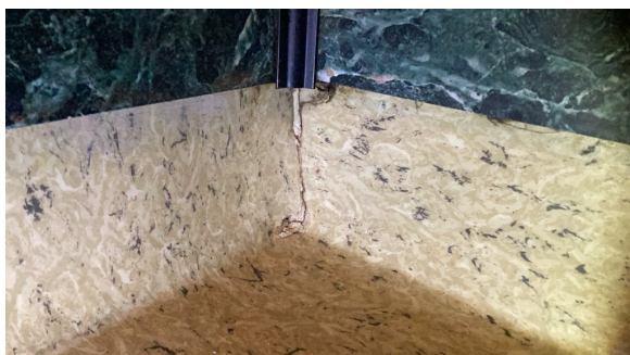
Det sprekker opp i vegg hjørne i dusjsone.
