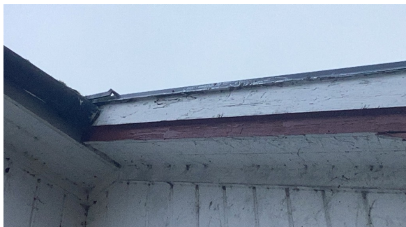
Råte i vindski.
