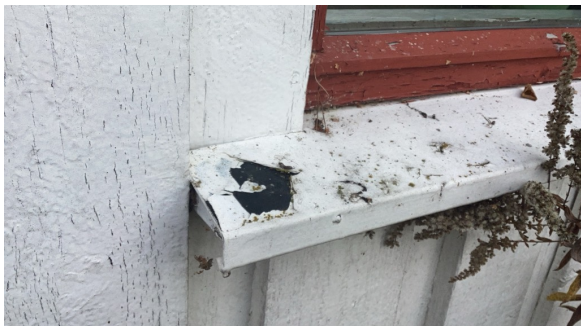
Eksempel på slitasje på beslag.
