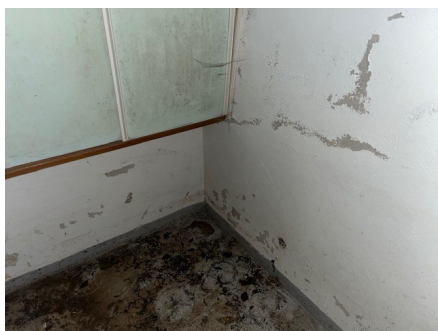
Eksempel på avskaling på vegg
