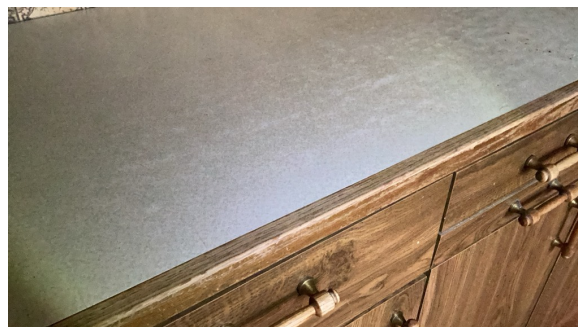
Eksempel på slitasje.
