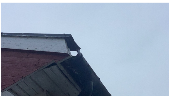
Det mangler endelokk på flere takrenner.
