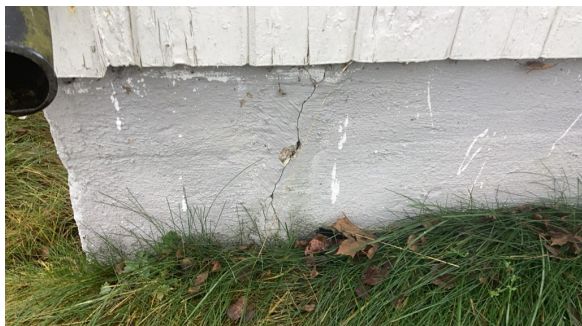
Eksempel på sprekk.
