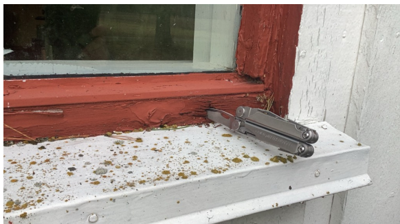
Eksempel på råteskade i vindu.
