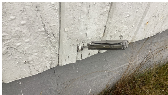
Eksempel på råte i kledning.
