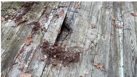
Råte på gulvbord på hovedveranda.
