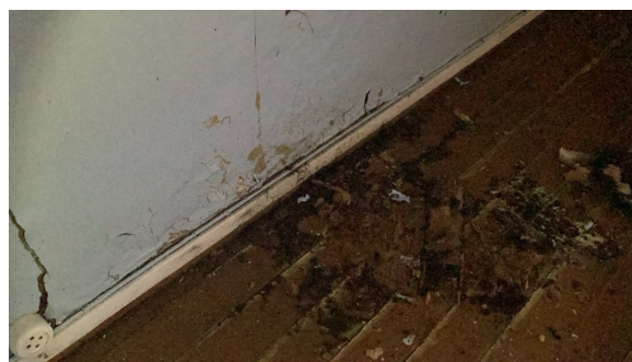
Skade etter lekkasje i 2. etasje.
