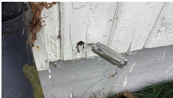
Eksempel på råte i kledning.
