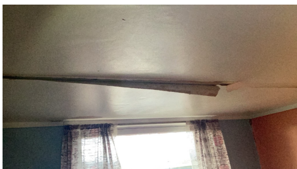
Tapet løsner i himling i 2. etasje.
