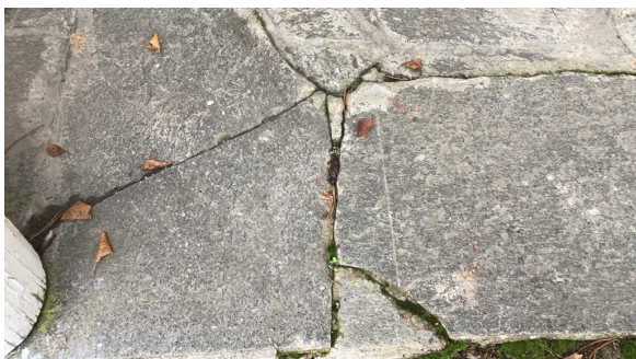
Det sprekker opp i fuger.
