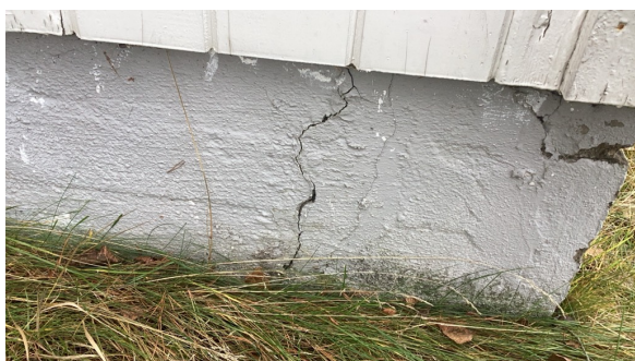
Eksempel på sprekk.
