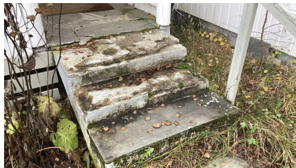
Avskalinger på trapp på tilbygg
