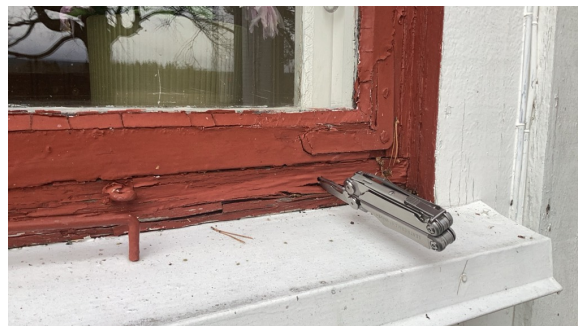
Eksempel på råteskade i vindu
