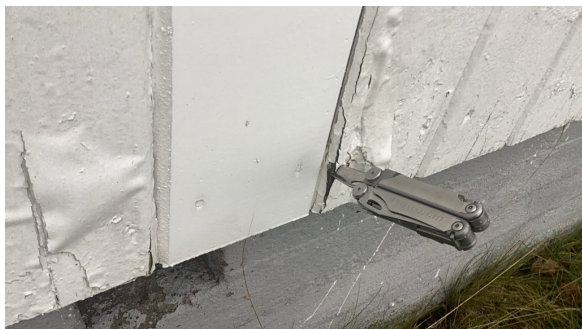
Eksempel på råte i kledning.
