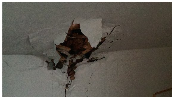
Det må forventes skade i selve takkonstruksjonen ifm. lekkasje på opprinnelig del.
