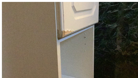
Eksempel på slitasje på front på skap.
