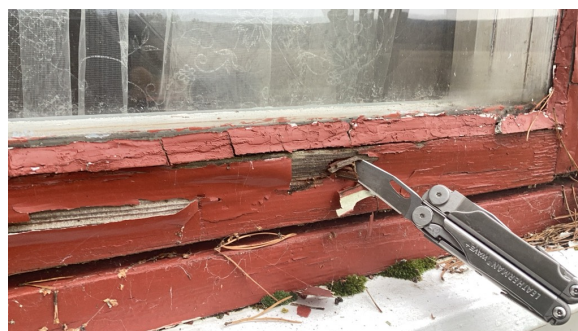
Eksempel på råteskade i vindu.
