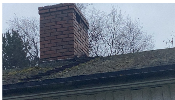
Det er opplyst at det har vært lekkasje rundt pipe i første tilbyggede del ved enkelte tilfeller.
