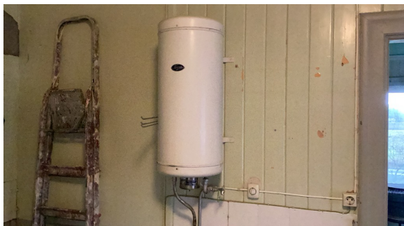
Varmtvannsbereder i 1. etasje.
