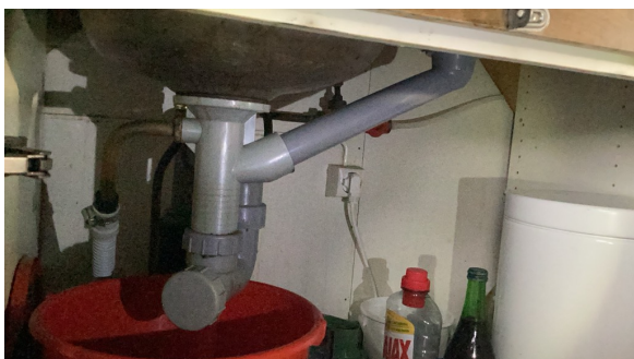
Lekkasje fra avløpsrør.
