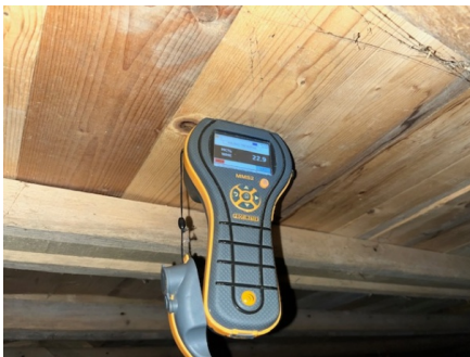
Fuktinnhold i treverk i kryperom på ca. 23 vektprosent.
