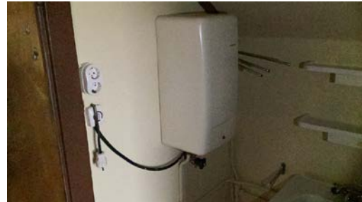
Varmtvannsbereder i 2. etasje.
