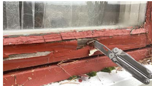
Eksempel på råteskade i vindu.
