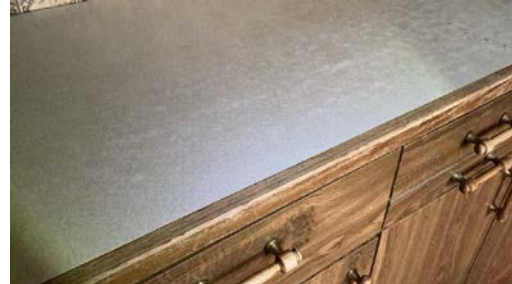
Eksempel på slitasje.
