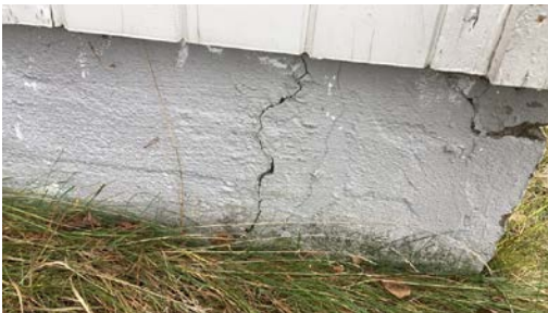
Eksempel på sprekk.
