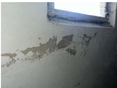
Eksempel på avskaling på vegg.
