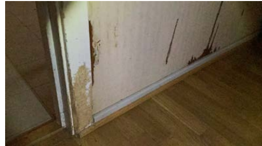
Slitasje på vegg i gang i 1. etasje.
