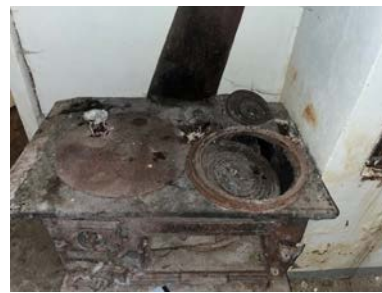
Skader på vedovn i kjeller.
