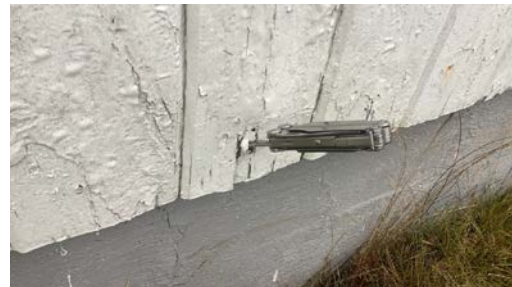
Eksempel på råte i kledning.
