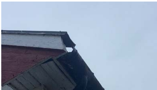
Det mangler endelokk på flere takrenner.
