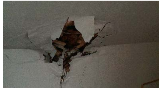
Det må forventes skade i selve takkonstruksjonen ifm. lekkasje på opprinnelig del.
