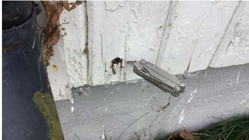
Eksempel på råte i kledning.
