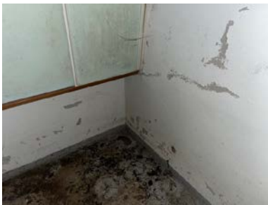
Eksempel på avskaling på vegg
