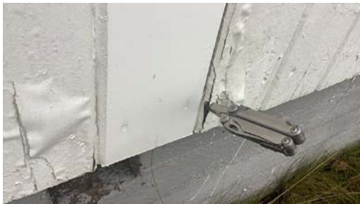
Eksempel på råte i kledning.
