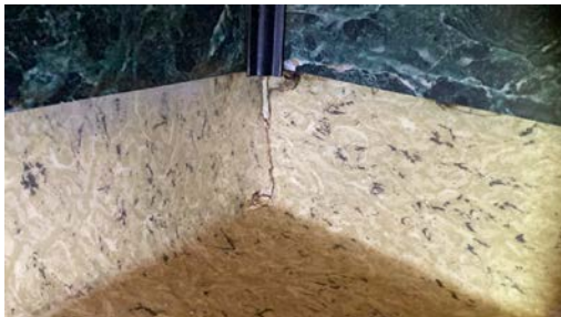
Det sprekker opp i veggghjørne i dusjsone.
