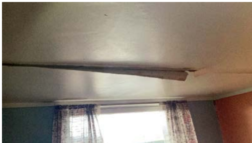
Tapet løsner i himling i 2. etasje.
