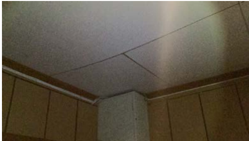
Lekkasje/fuktskader i himling i gang i 1. etasje.
