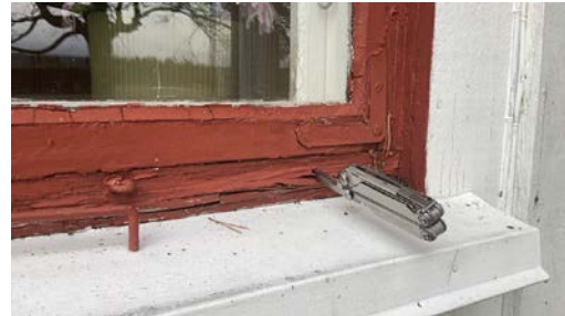
Eksempel på råteskade i vindu
