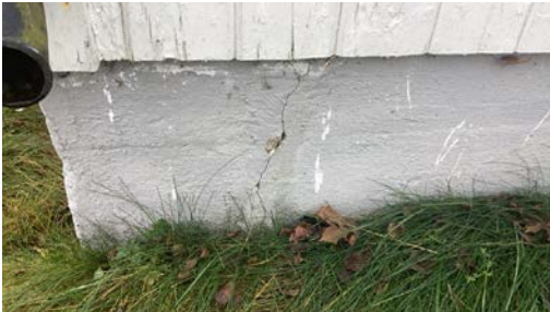
Eksempel på sprekk.
