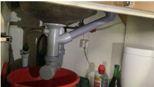
Lekkasje fra avløpsrør.
