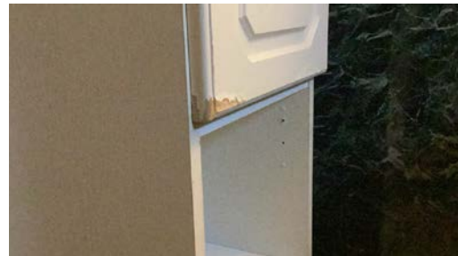
Eksempel på slitasje på front på skap.
