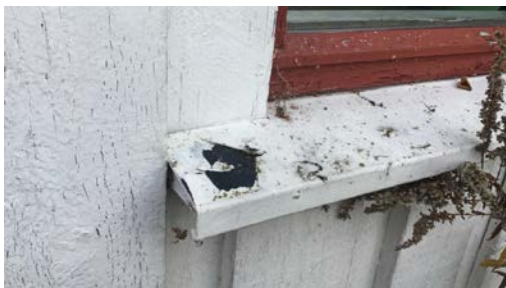
Eksempel på slitasje på beslag.
