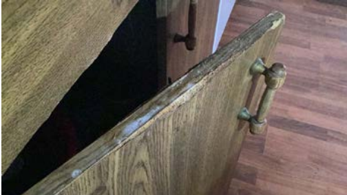
Eksempel på slitasje.
