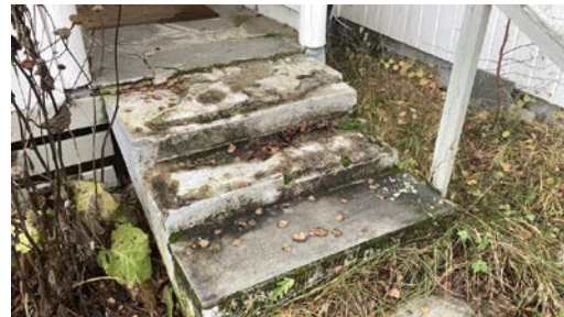
Avskalinger på trapp på tilbygg
