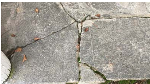
Det sprekker opp i fuger.
