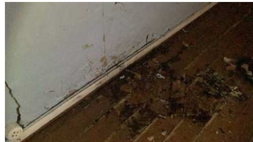
Skade etter lekkasje i 2. etasje.
