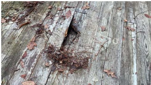
Råte på gulvbord på hovedveranda.
