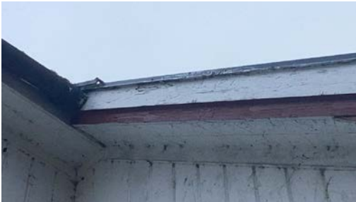
Råte i vindski.
