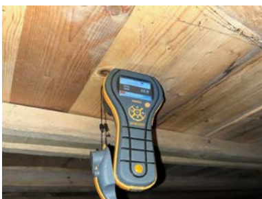
Fukttinnhold i treverk i kryperom på ca. 23 vektprosent.
