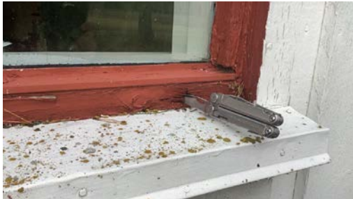
Eksempel på råteskade i vindu.
