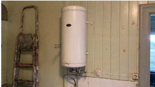
Varmtvannsbereder i 1. etasje.
