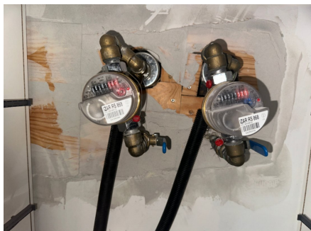
Stoppekran plassert på kjøkken
