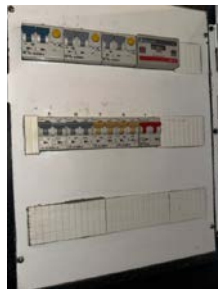
Sikringsskap med automatsikringer.
