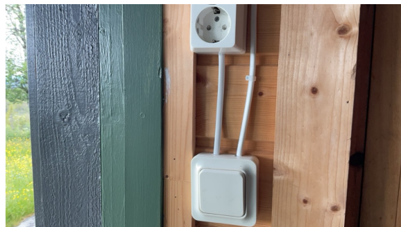
Ufagmessig utførelse på deler av anlegget.
