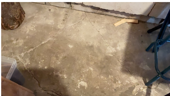
Sprekker i gulv registrert i bod.
