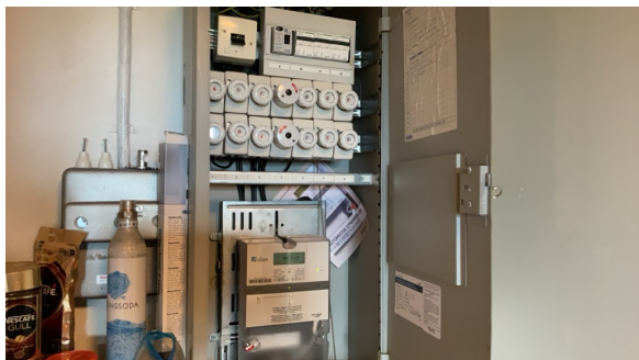
Sikringsskap plassert på kjøkken.
