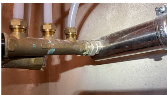
Irr/Korrodering på kobling.
