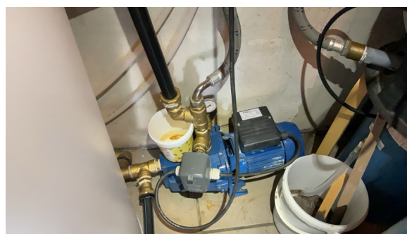
Vannpumpe plassert på teknisk rom
