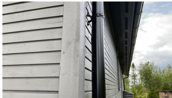
Frostspreg på takrennenedløp.
