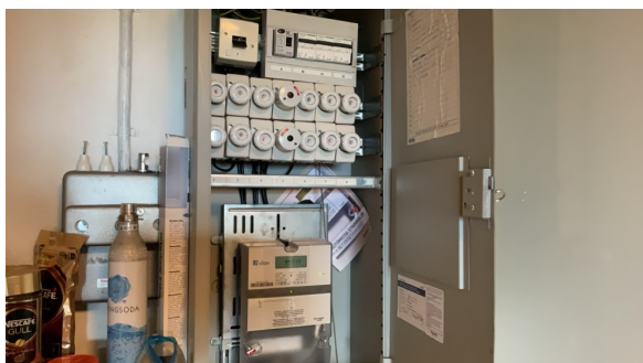
Sikringsskap plassert på kjøkken.
