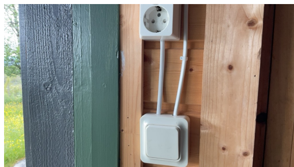
Ufagmessig utførelse på deler av anlegget.
