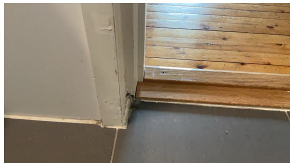
Ingen synlig oppbrett av membran ved terskel.
