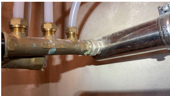
Irr/Korrodering på kobling.
