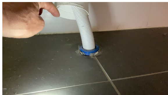
Utettheter i membran rundt rørgjennomføringer.
