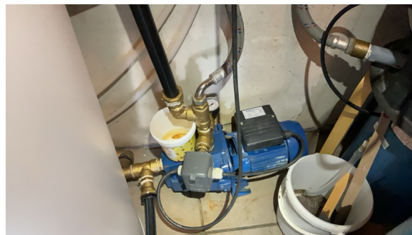
Vannpumpe plassert på teknisk rom
