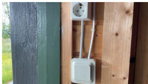
Ufagmessig utførelse på deler av anlegget.
