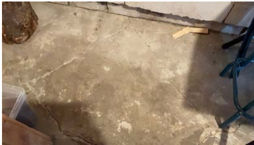
Sprekker i gulv registrert i bod.
