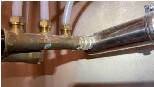
Irr/korrodering på kobling.
