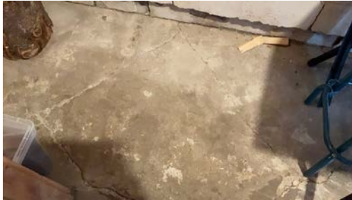
Sprekker i gulv registrert i bod.
