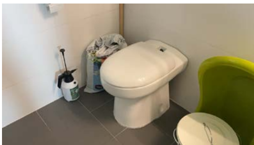
Biotoalett plassert på bad.
