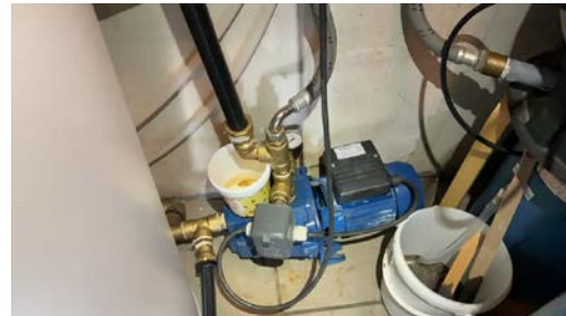
Vannpumpe plassert på teknisk rom
