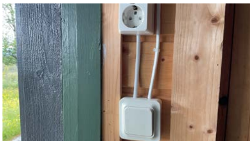
Ufagmessig utførelse på deler av anlegget.
