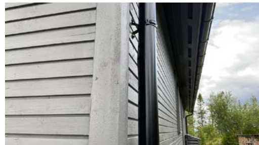
Frostspreg på takrennenedløp.
