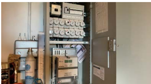
Sikringsskap plassert på kjøkken.
