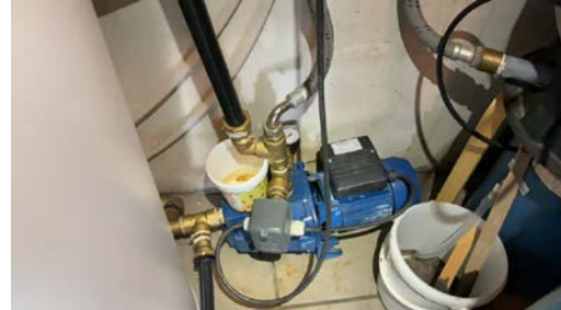
Vannpumpe plassert på teknisk rom
