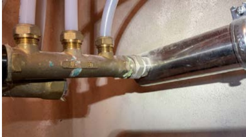
Irr/korrodering på kobling.
