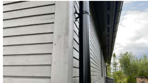
Frostspreg på takrennenedløp.
