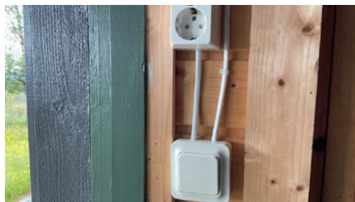
Ufagmessig utførelse på deler av anlegget.
