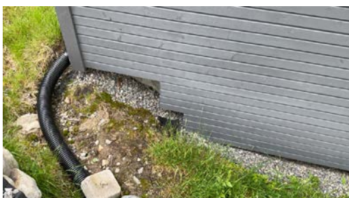
Lav høyde mellom grunnen og kledning, risiko for skader. Anbefalt høyde mellom terreng og kledning er 30 cm.
