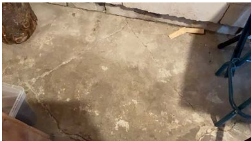
Sprekker i gulv registrert i bod.
