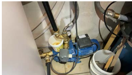
Vannpumpe plassert på teknisk rom
