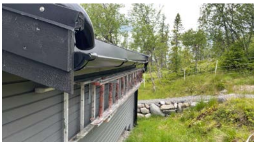
Takrenner har blitt bøyd, sannsynligvis som følge av snøras.
