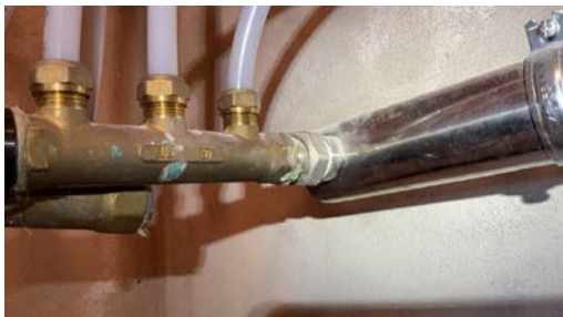
Irr/korrodering på kobling.
