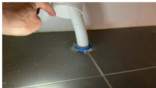
Utettheter i membran rundt rørgjennomføringer.
