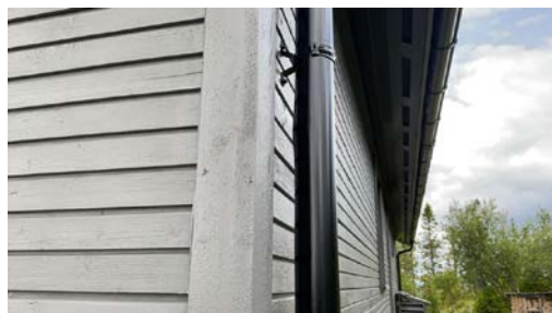
Frostspreg på takrennenedløp.
