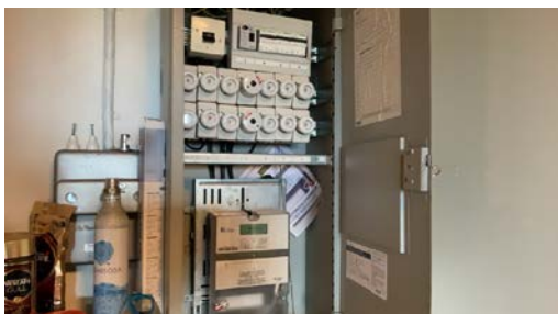
Sikringsskap plassert på kjøkken.
