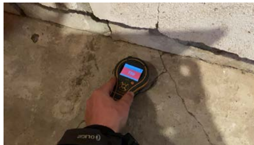
Med enkle fuktsøk i bod ble det registrert områder med forhøyede verdier.
