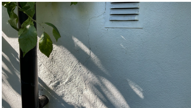
Sprekk i grunnmur.
