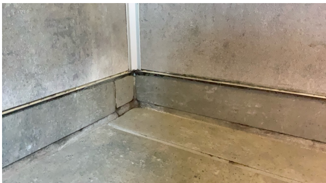
Eksempel på svertesopp i dusjsone.
