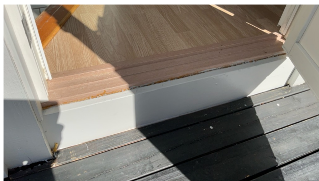
Beslag mangler ved terskel.
