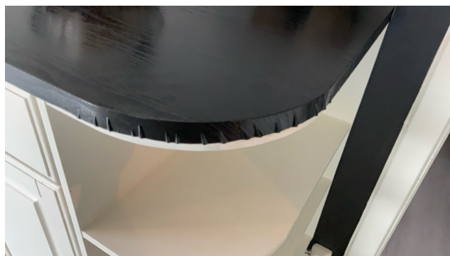
Eksempel på ufagmessig utførelse på foliering av benkeplate.
