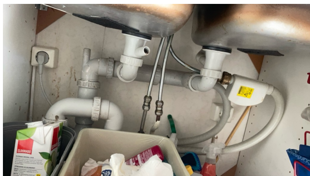
Avløpsrør av plast under kjøkkenbenk.
