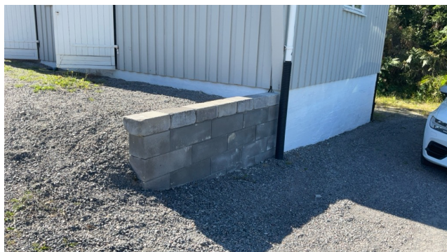
Støttemur uten rekkverk.
