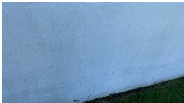
Sprekk i grunnmur.
