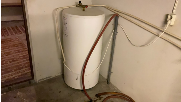
Bereder montert i kjeller.
