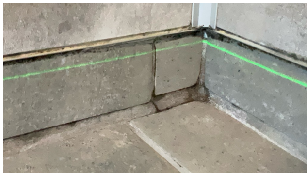
Riss/sprekker i flisfuger i våtsone.
