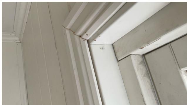
Eksempel på ufagmessig utførelse på diverse overflater.
