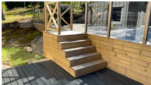
Trapp mangler rekkverk.
