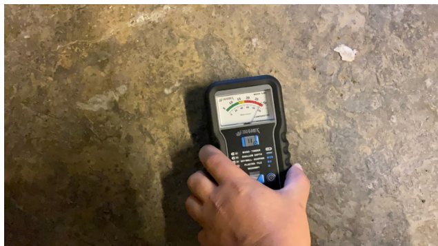
Fuktindikator reagerer på fuktighet i betonggulv i kjeller.
