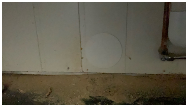
Hull forsvarlig plombert.
