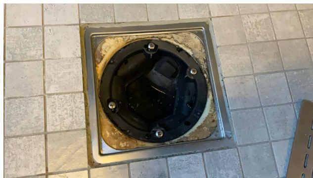
Plastsluk med synlig vinylbelegg.
