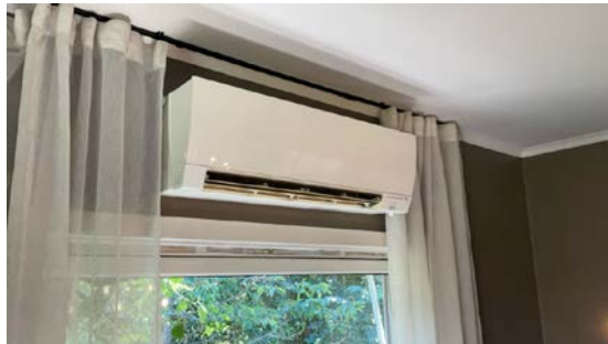
Luft til luft varmepumpe.
