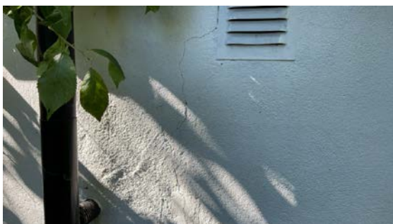
Sprekk i grunnmur.
