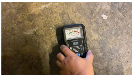
Fuktindikator reagerer på fuktighet i betonggulv i kjeller.
