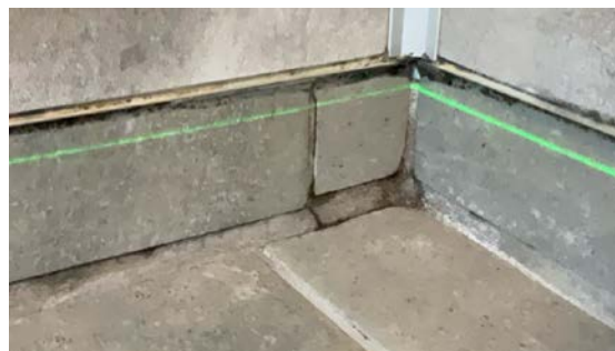
Riss/sprekker i flisfuger i våtsone.
