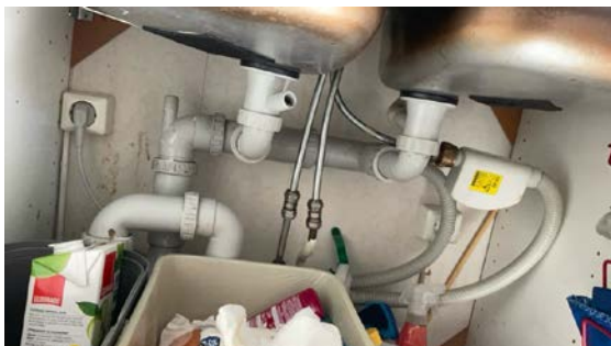
Avløpsrør av plast under kjøkkenbenk.
