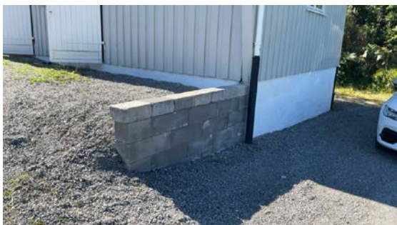
Støttemur uten rekkverk.
