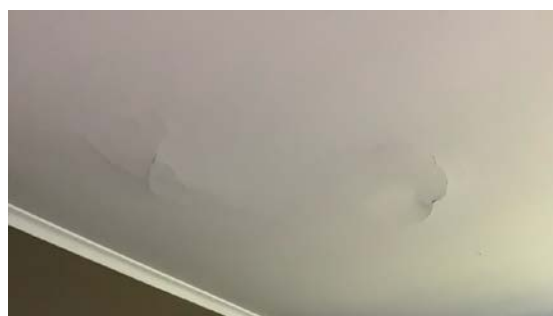
Skade i himlig.
