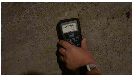
Fuktindikator reagerer på fuktighet i betongvegg i kjeller.
