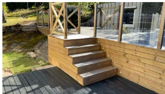
Trapp mangler rekkverk.
