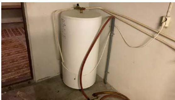
Bereder montert i kjeller.
