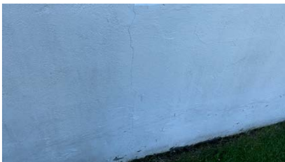
Sprekk i grunnmur.
