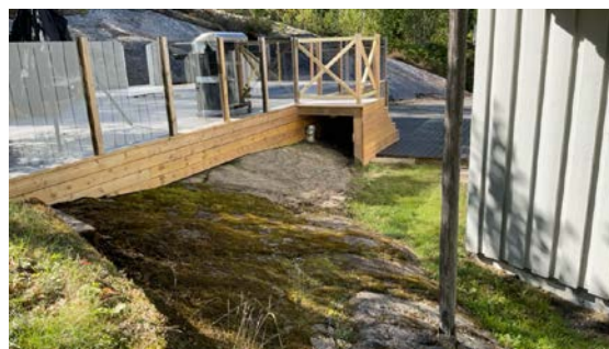
Eksempel på at fjell har fall mot bygning.
