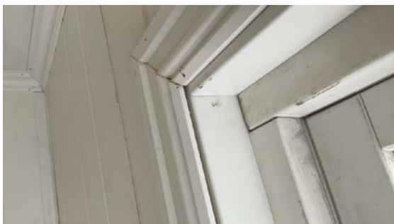
Eksempel på ufagmessig utførelse på diverse overflater.
