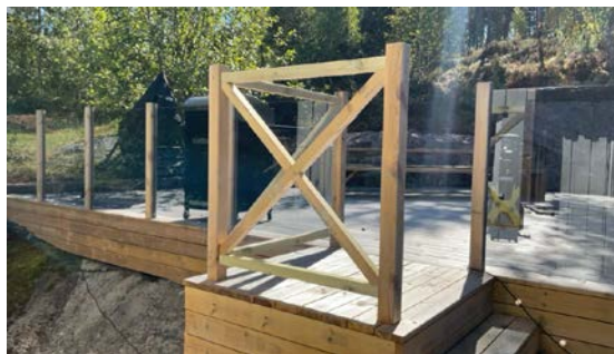
For store åpninger i rekkverk.
