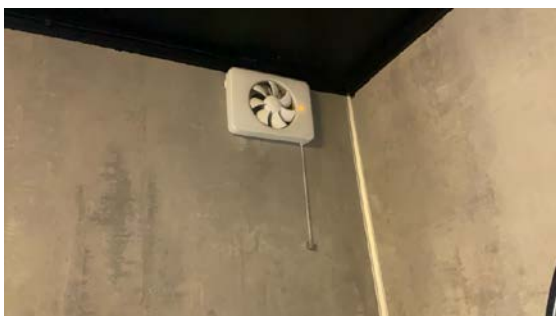
Elektrisk styrt avtrekksvifte.
