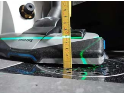
Referansenivå laser = 5 cm til topp tettesjikt under flis ved dør. Viser ca. samme høyde på tettesjiktet til topp slukrist.
