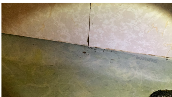
Begynnende fuktskader nederst på veggplater.
