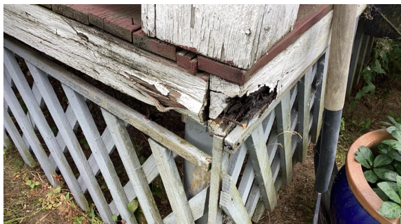
Råteskade på veranda.
