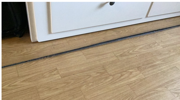
Eksempel på gulvbelegg som løsner i skjøt.
