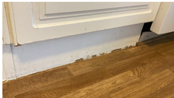
Eksempel på slitasje.
