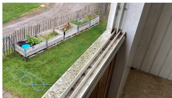
Eksempel på slitasje.
