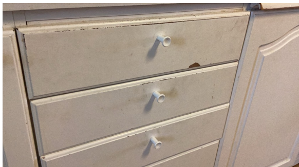
Eksempel på slitasje.
