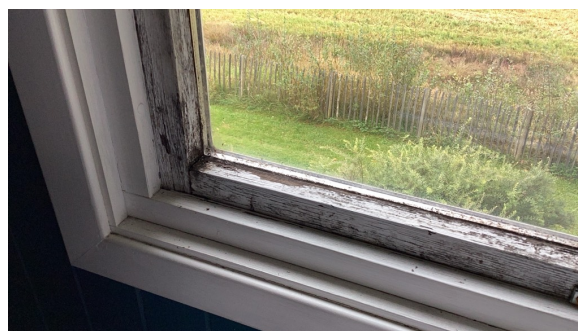
Eksempel på innvendig slitasje.
