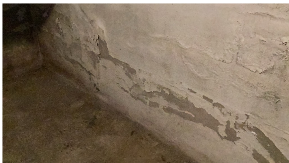
Eksempel på avskaling på vegg
