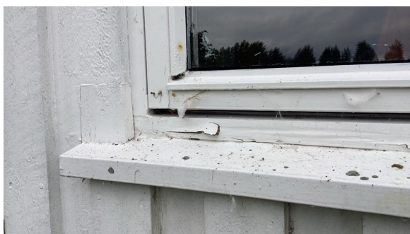
Maling begynner å skale av på vindu.
