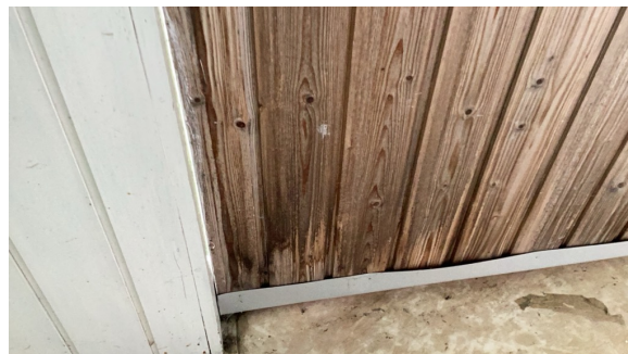
Fuktmerker på rekkverk på balkong.
