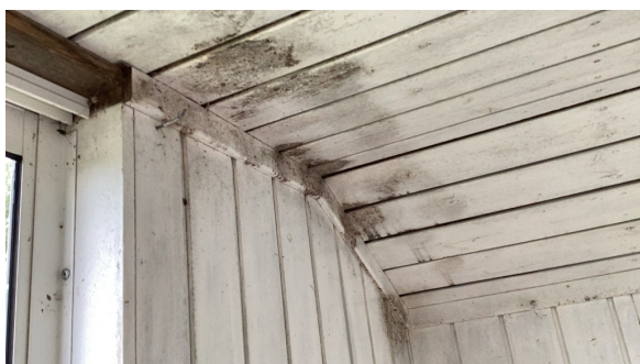
Fuktmerker og svertesopp i himling på balkong.
