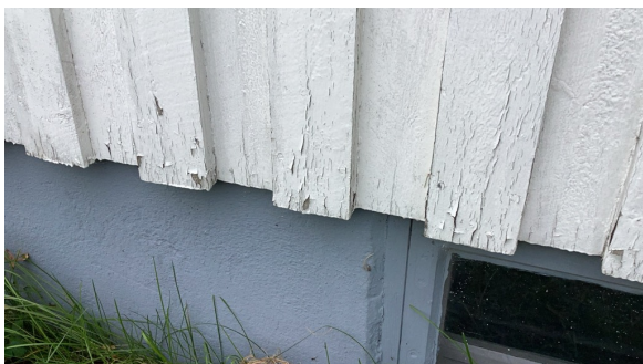
Eksempel på avskaling av maling.
