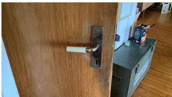
Eksempel på slitasje.
