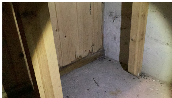
Synlig fuktpåkjenning på trevegg.
