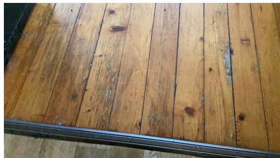
Slitasje på tregulv.
