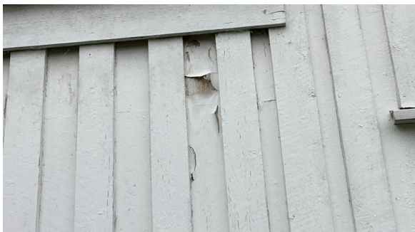
Eksempel på avskaling av maling.
