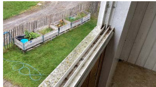
Eksempel på slitasje.
