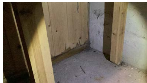
Synlig fuktpåkjenning på trevegg.
