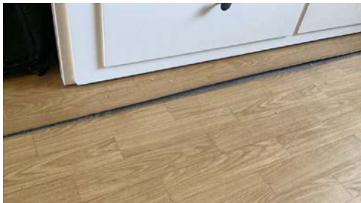
Eksempel på gulvbelegg som løsner i skjøt.
