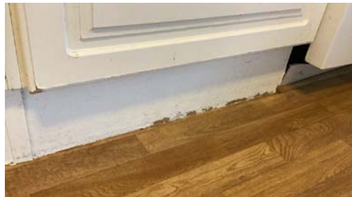
Eksempel på slitasje.
