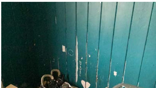
Eksempel på slitasje.
