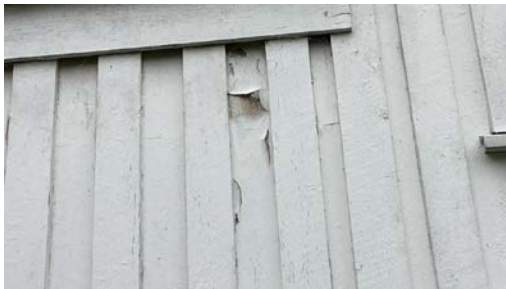
Eksempel på avskaling av maling.
