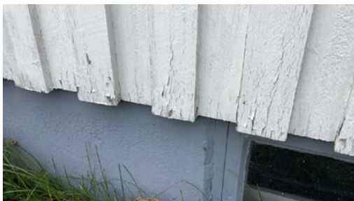
Eksempel på avskaling av maling.
