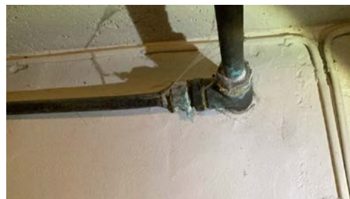
Det drypper fra noen skjøter.
