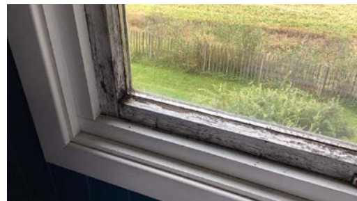
Eksempel på innvendig slitasje.
