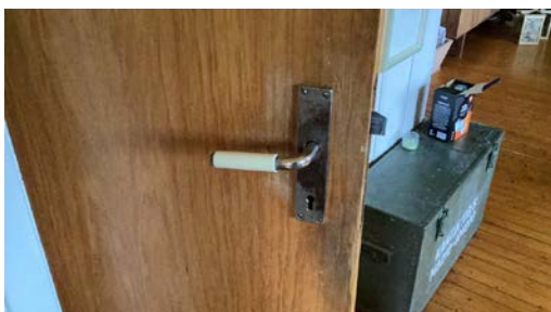
Eksempel på slitasje.
