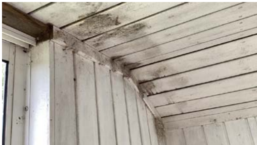
Fuktmerker og svertesopp i himling på balkong.
