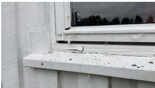
Maling begynner å skale av på vindu.
