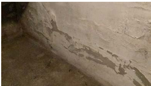
Eksempel på avskaling på vegg
