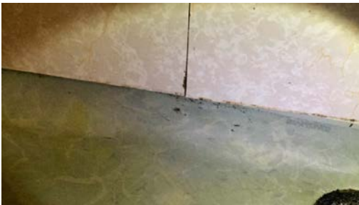
Begynnende fuktskader nederst på veggplater.
