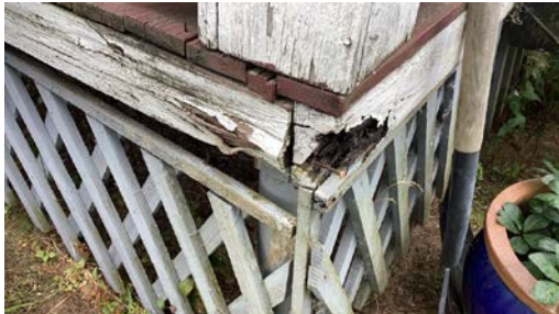
Råteskade på veranda.
