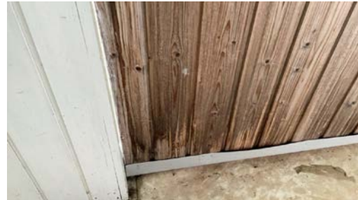
Fuktmerker på rekkverk på balkong.
