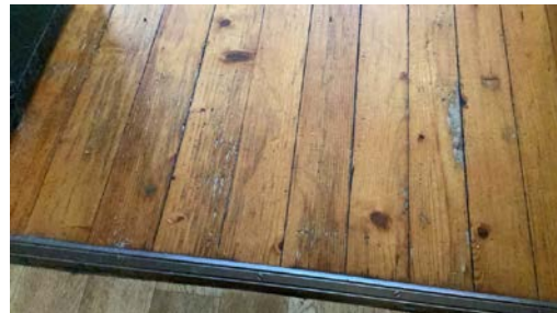
Slitasje på tregulv.
