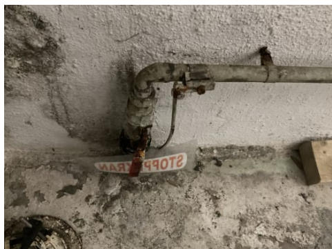
Rust i vannrør.
