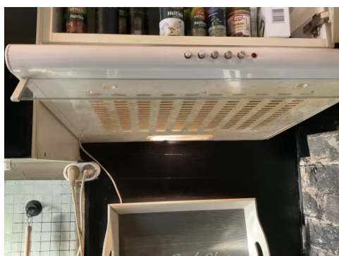
Komfyrvakt er ikke montert.
