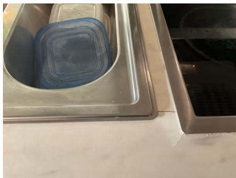
Sprekk i benkeplate
