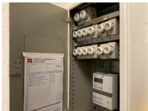
Sikringsskap plassert i gang (leilighet)
