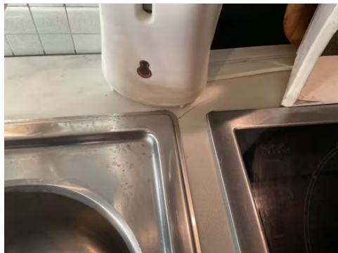
Sprekk i benkeplate
