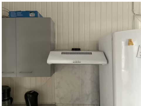
Avtrekk ikke tilkoblet.
