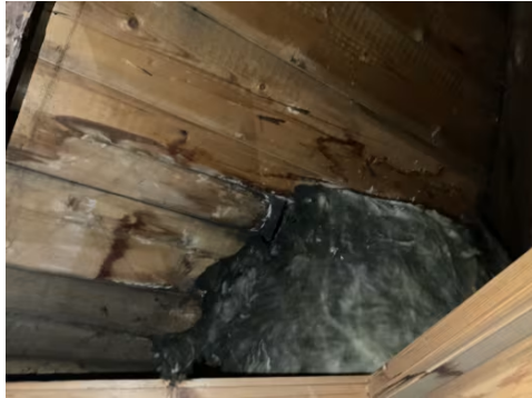
Synlig tegn på fuktproblematikk.
