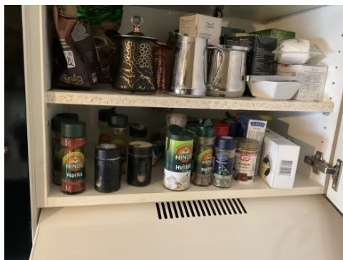
Ikke etablert mekanisk avtrekk.
