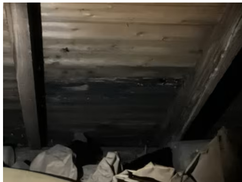
Undertak med fuktproblemer.
