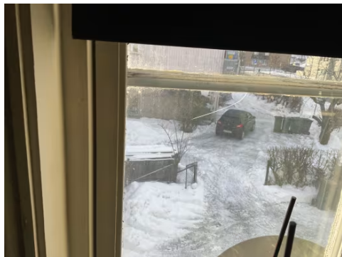
Sprekk i vindu 2.etg Leilighet 2
