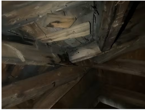
Fuktmerker i undertak.
