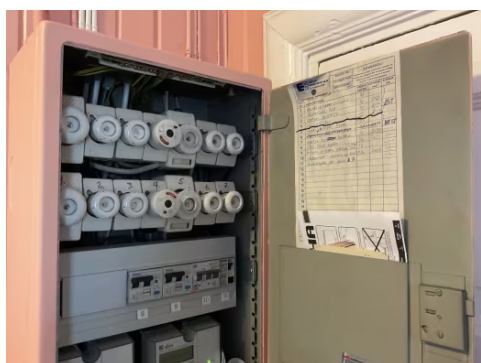
Sikringsskap plassert 2-.etg.
