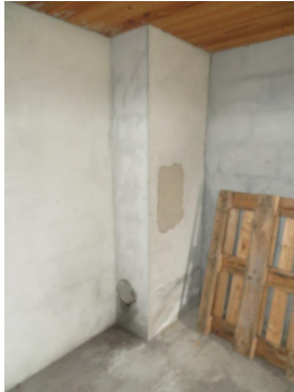
Sotluke i kjeller. Merk at det har vært endel avrenning fra luken - antatt regnvann pga manglende pipehatt.
