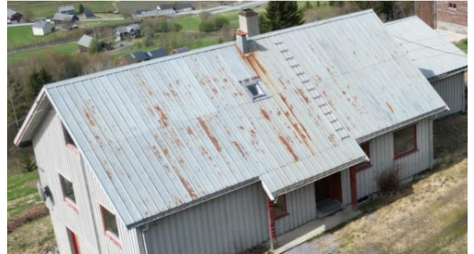
Stedvis rust i takplatene.
