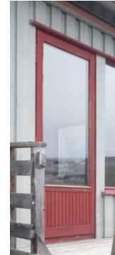
Terrassedør med vedlikeholdsbehov. NB: Merk punktert glass.
