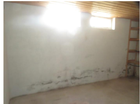
Synlige partier med fuktopptrekk/fuktgjennomslag.
