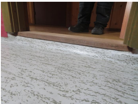
Belegg ført opp på dørterskel som flomsikring og som kompensasjon for manglende fall på gulv.
