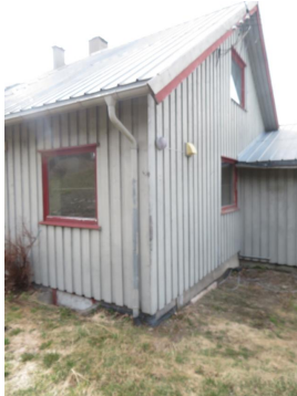
Nedløpsrør ført til nedgravd drenerør til terreng.
