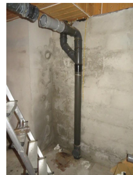
Synlige partier med fuktopptrekk/fuktgjennomslag.
