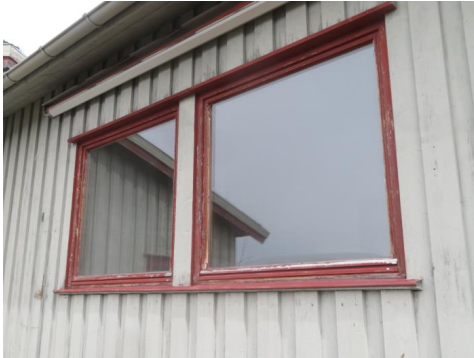
Vinduer med renoveringsbehov.
