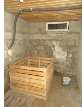
Synlige partier med fuktopptrekk/fuktgjennomslag.
