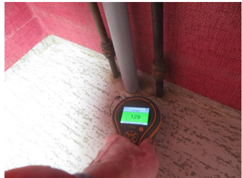
Fuktsøk i gulv rundt rørgjennomføringer som er montert uten mansjett. Ingen påviste avvik.
