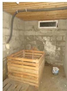
Synlige partier med fuktopptrekk/fuktgjennomslag.
