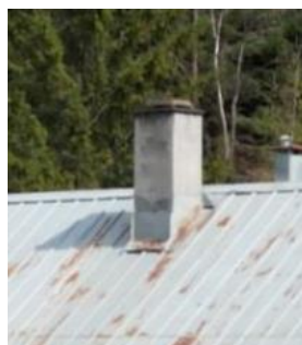
Pipe over tak som pusset. Merk at pipehatt mangler.
