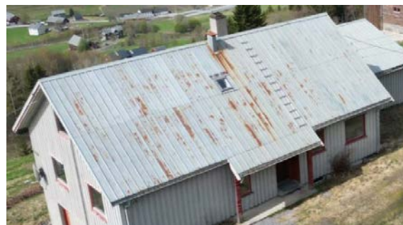
Stedvis rust i takplatene.
