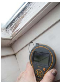
Takvindu på bad i 2.etg ses med tidligere spor etter vannlekkasje/kondensvann. Fuktsøk viser pr. dd ingen forhøyede fuktverdier.
