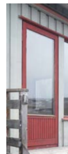
Terrassedør med vedlikeholdsbehov. NB: Merk punktert glass.
