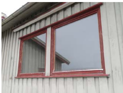
Vinduer med renoveringsbehov.
