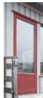
Terrassedør med vedlikeholdsbehov. NB: Merk punktert glass.
