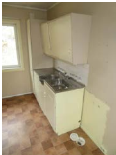
Kjøkken fremstår med naturlige renoveringsbehov jfr. alder.
