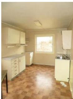
Kjøkken fremstår med naturlige renoveringsbehov jfr. alder.
