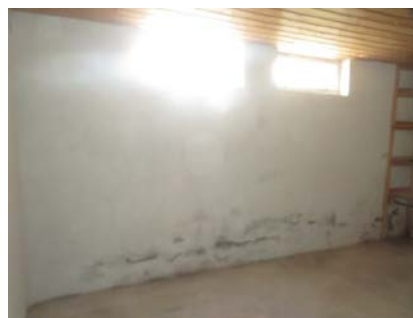
Synlige partier med fuktopptrekk/fuktgjennomslag.
