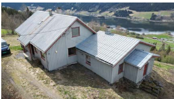
Tak uten snøfangere (Var ikke krav ved byggeår).
