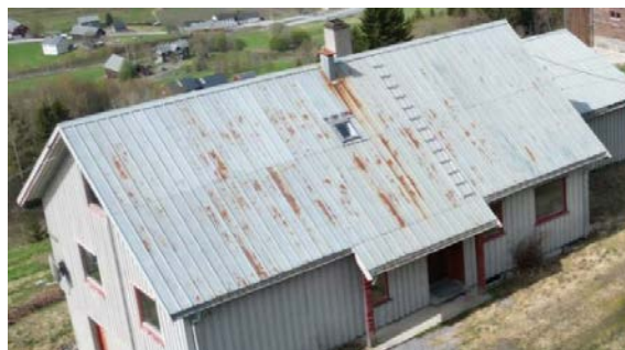
Stedvis rust i takplatene.
