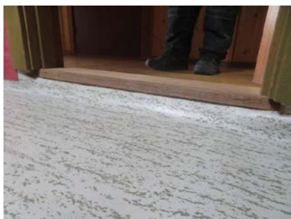
Belegg ført opp på dørterskel som flomsikring og som kompensasjon for manglende fall på gulv.
