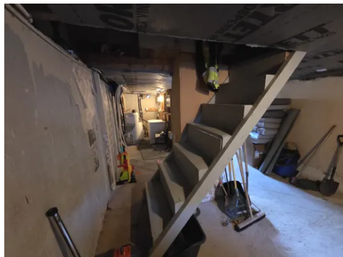
Trapp ned til grovkjeller mangler rekkverk og håndløper.
