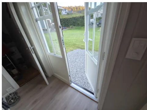
Balkongdør kjøkkenet må sikres.
