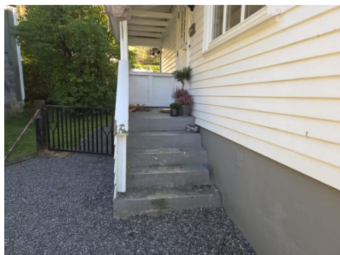
Utvendig trapp mangler håndløper.
