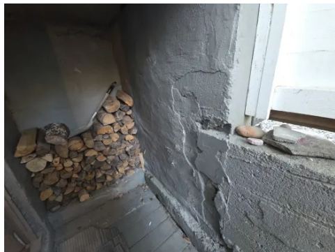
Mur ved inngang. Bør repareres med puss.
