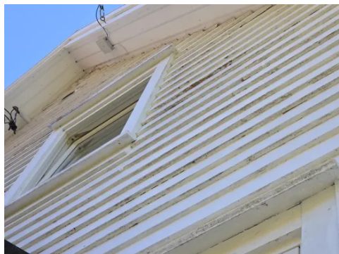
Oversikt kledning på nordsida. Kledning er noe værslitt, vanlig svertesopp finnes.
