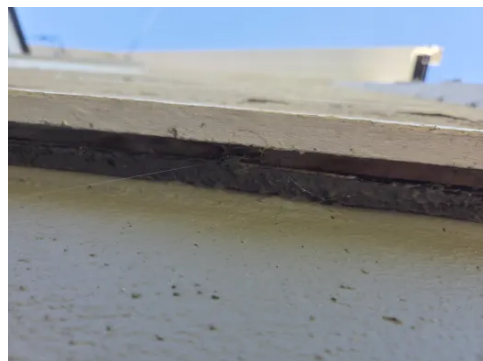
Lite/ingen lufting bak kledning på nordsida.
