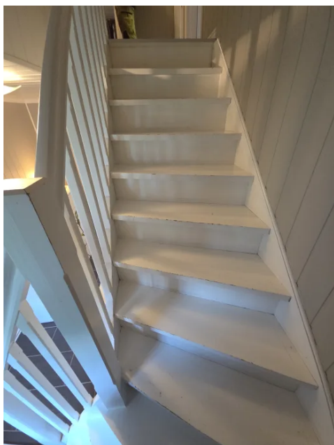
Trapp opp til 2.etg. mangler håndløper.
