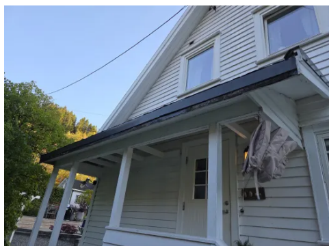
Takrenne mangler ved inngangsparti.
