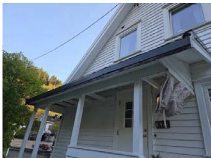
Takrenne mangler ved inngangsparti.
