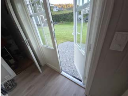
Balkongdør kjøkken må sikres.
