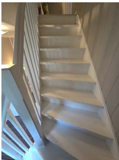
Trapp opp til 2.etg. mangler håndløper.
