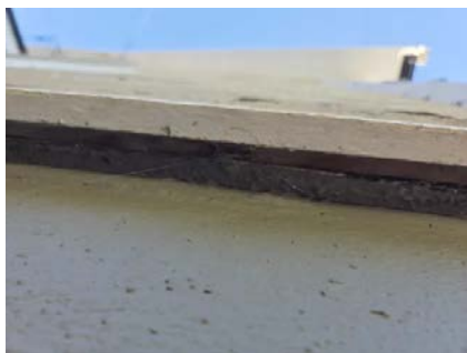
Lite/ ingen lufting bak kledning på nordsida.
