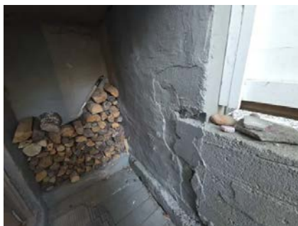
Mur ved inngang. Bør repareres med puss.
