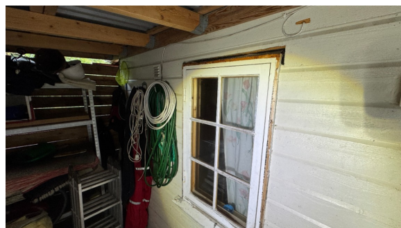
Utvendig omramming rundt vinduer mangler.
