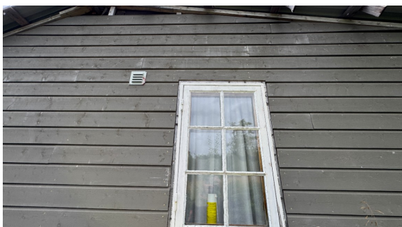
Utvendig omramming rundt vinduer mangler.
