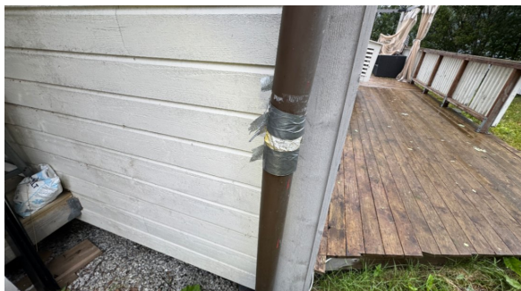
Ufagmessig utførelse av taknedløp.
