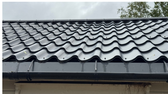
Taktekke er feilmontert og det er registrert nedbøying i taktekke.
