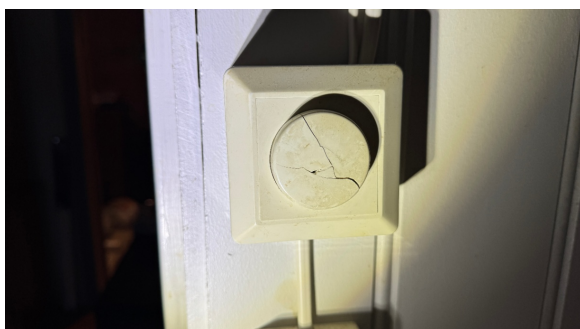
Skade på lysbryter.
