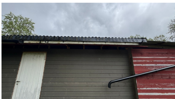
Deler av takrennen mangler.
