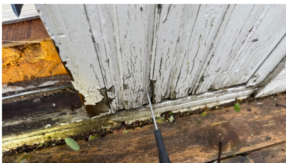
Terrassedøren har råteskader.
