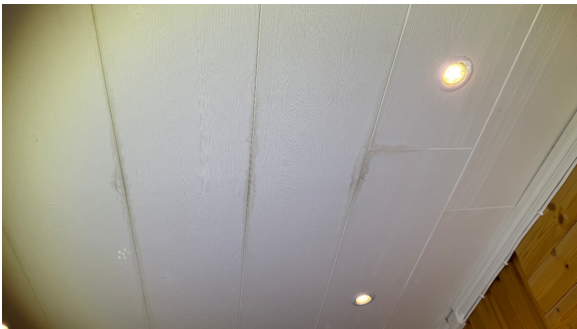
Det er fuktmerker i himlingen.
