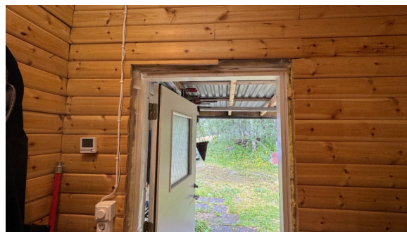
Inngangsdøren mangler foringer og lister.
