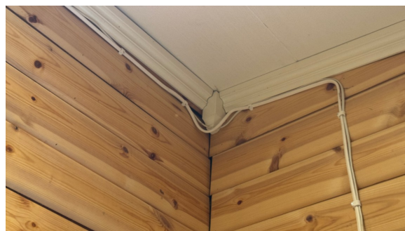
Ufagmessig utførelse av el-anlegg.
