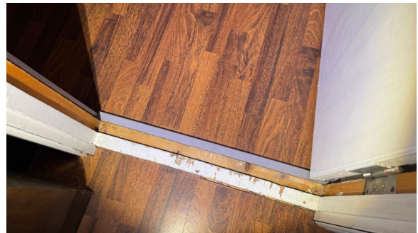
Det er registrert noe ufagmessige avslutninger mot dører.
