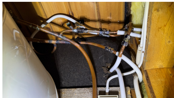
Det er påvist ufagmessig utførelse av vannledninger.
