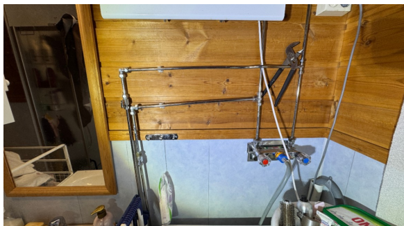
Det er påvist ufagmessig utførelse av vannledninger.
