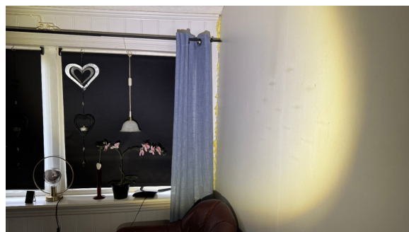
Det er lagt isolasjon i hjørnet på stuen, noe som tyder på kaldtrekk.
