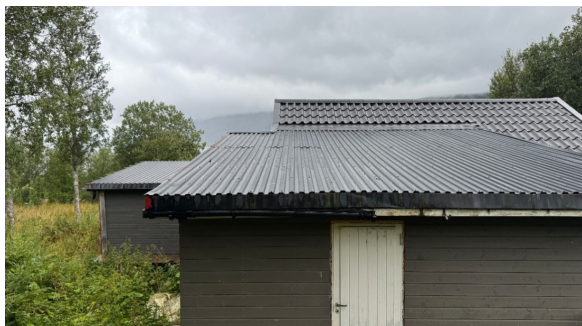
Det er registrert noe rust og bulker i taktekke.
