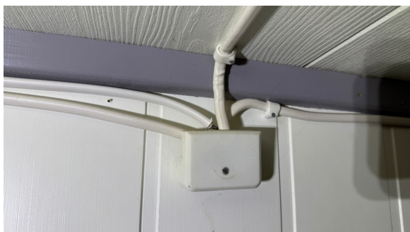
Ufagmessig utførelse av el-anlegg.
