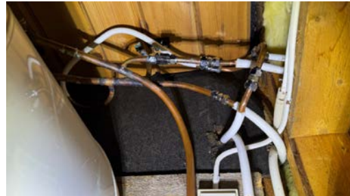
Det er påvist ufagmessig utførelse av vannledninger.
