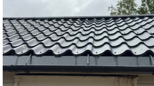
Taktekke er feilmontert og det er registrert nedbøying i taktekke.
