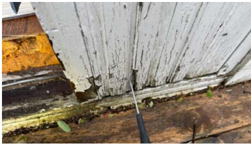
Terrassedøren har råteskader.
