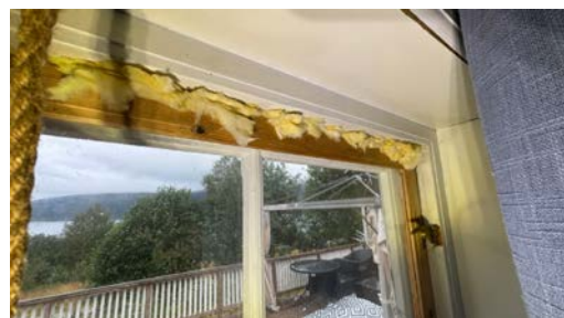
Det er lagt isolasjon mellom vinduskarm og glass, dette tyder på kaldtrekk.
