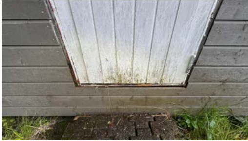
Boddør er utvendig værslett og mangler utvendig omramming.
