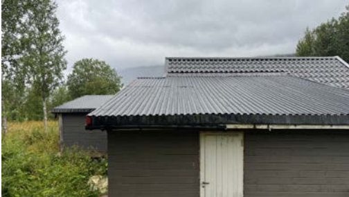
Det er registrert noe rust og bulker i taktekke.
