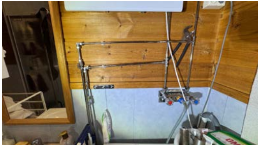
Det er påvist ufagmessig utførelse av vannledninger.
