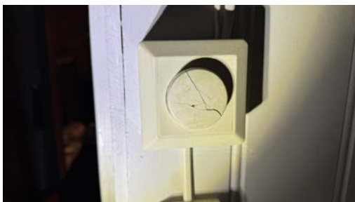
Skade på lysbryter.
