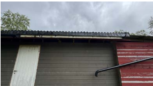
Deler av takrennen mangler.
