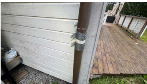
Ufagmessig utførelse av taknedløp.
