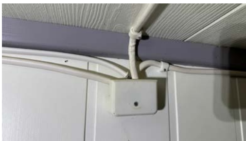
Ufagmessig utførelse av el-anlegg.
