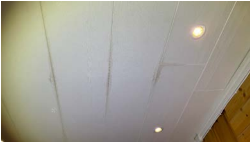
Det er fuktmerker i himlingen.
