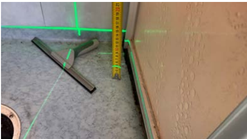
Det er registrert motfall mot sluken.
