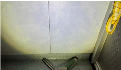
Det er registrert ujevnheter/utbuling i veggplater i dusjsonen.
