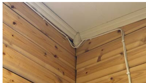
Ufagmessig utførelse av el-anlegg.
