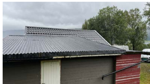
Det mangler snøfangere på hele eller deler av taket, noe som var krav på byggemeldingstidspunktet.
