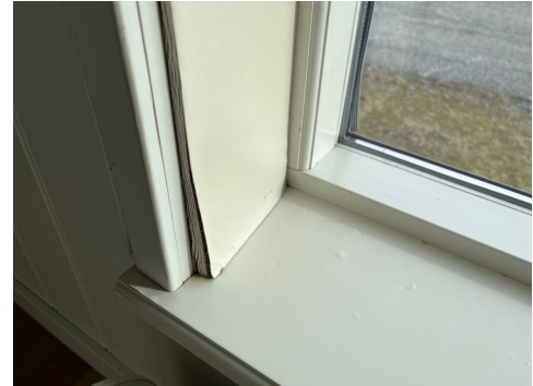
Soveromsvindu med skade i utforing.
