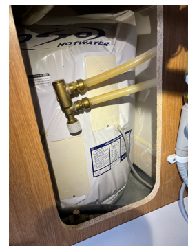
Varmtvannsbereder i kjøkkenbenk.
