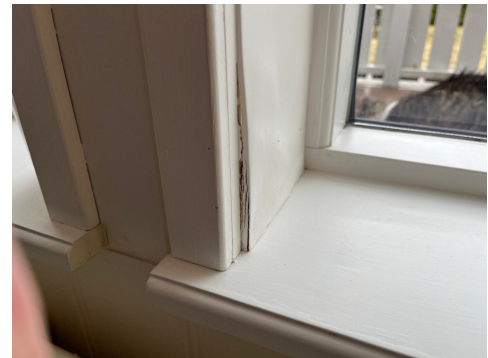
Stuevindu med skade i utforing.
