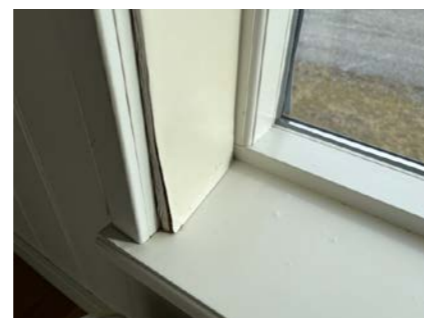
Soveromsvindu med skade i utforing.
