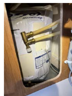
Varmtvannsbereder i kjøkkenbenk.
