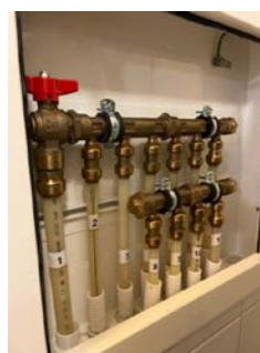
Fordelerskap med stoppekran.
