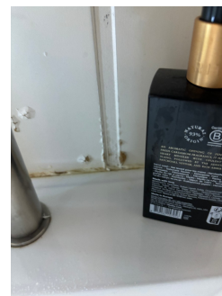
Svelleskader i mdf-panel bak servant.
