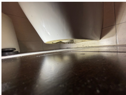
Avrenningsåpning / spalte ved gulv for eventuell lekkasjevann fra innebygd toalettsisterner mangler.
