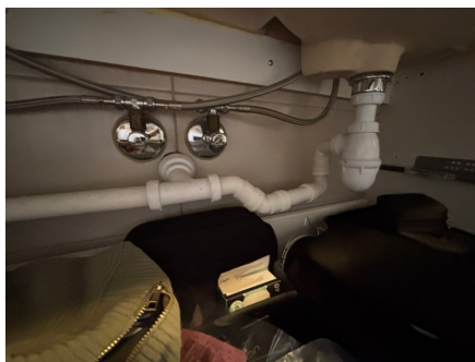
Motfall på avløpsrør.
