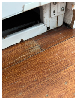
Fuktskade i parkett foran kjøleskap.
