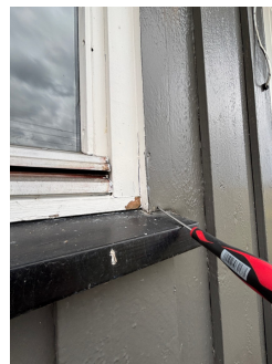
Omramminger for tett ned på vindusbeslag.
