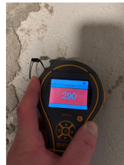
Indikasjoner på fukt ved fuktsøk
