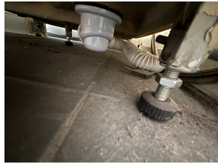
Dusjkabinetts avløp går ikke i sluk, men i lukket avløp.
