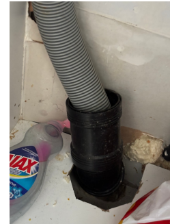
Utilfredstillende tilkobling av avløp i benkeskap.
