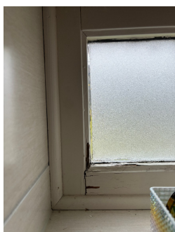
Maling flasset av på vindu innvendig.
