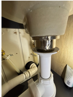
Lekkasje på avløp under servant.
