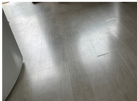
Svelleskader i skjøter på laminat.
