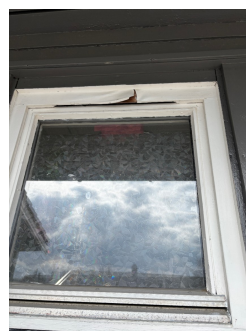
Maling flasset av på vindu utvendig.
