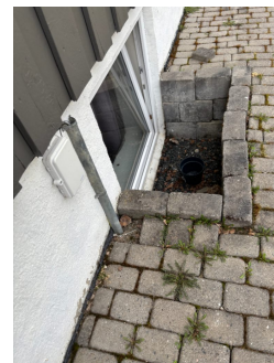
Grunnmurslist mangler i overkant av knotteplast.
