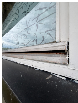
Behov for vedlikehold av utvendige karmen/rammer.
