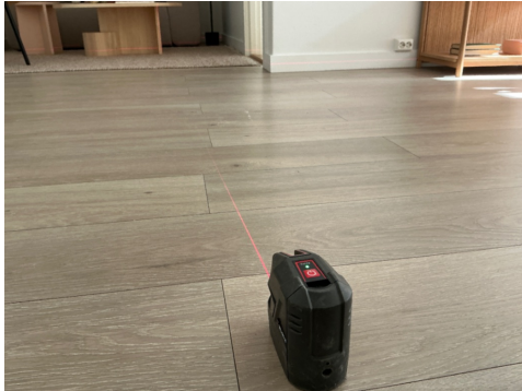
Nivellering stue + soverom, avvik ca. 10-20 mm
