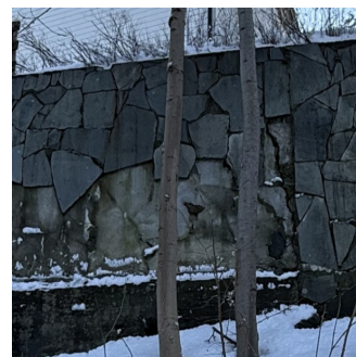
Manglede skifer og vertikal sprekk mot nord
