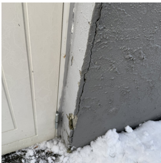
Manglende beslag under dør og løs puss
