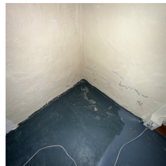
Saltutslag i vegg og gulv under trapp
