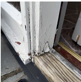
Råte i karm og sidevindu hovedytterdør
