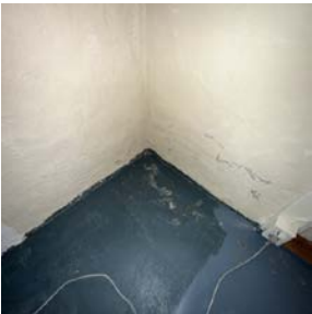
Saltutslag i vegg og gulv under trapp
