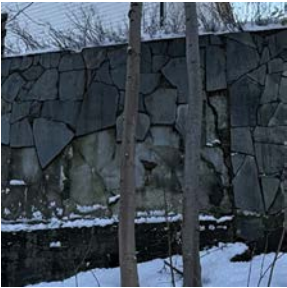
Manglede skifer og vertikal sprekk mot nord
