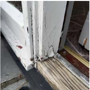
Råte i karm og sidevindu hovedytterdør
