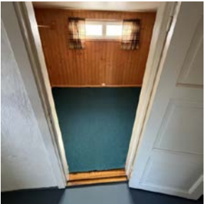
Noe svikt i gulv rett på innsiden av døren til bod i sørøst
