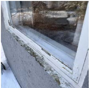
Koblede vindu, har behov for vedlikehold og mangler beslag.
