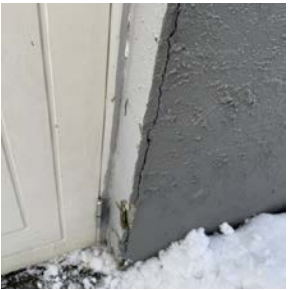
Manglende beslag under dør og løs puss
