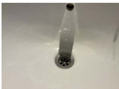
Det er påvist riss/sprekker i utstyr på våtrommet.
