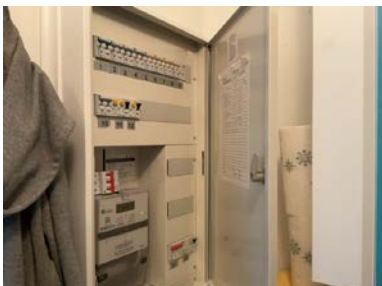
Sikringsskap plassert på bod.
