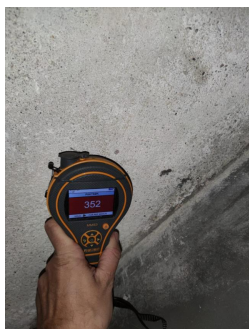
Indikert høye fuktverdier i vegg i bod mot øst.
