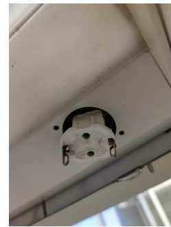
Løs stikk i lysarmatur på bad gir tg 3.
