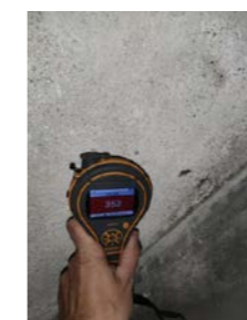
Indikert høye fuktverdier i vegg i bod mot øst.
