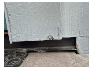
Noe overmalt råte i kledning ved inngangsparti.
