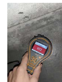
Indikert høye fuktverdier i gulv i bod mot øst.
