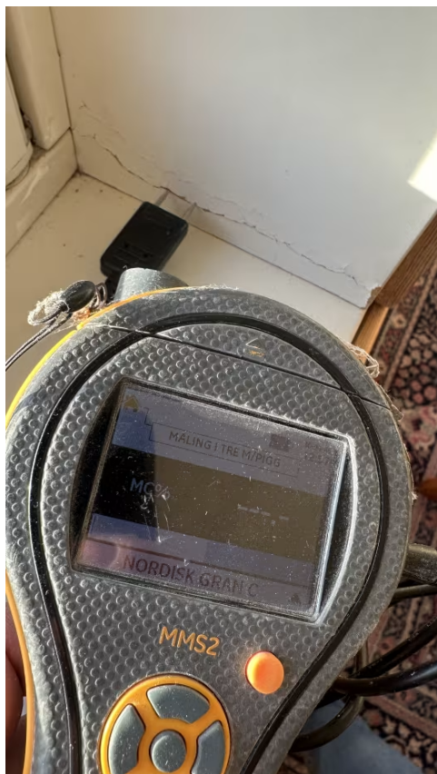
Registrert svelling i vindusforing kjøkken
