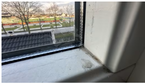
Delaminering av glass på soverom.
