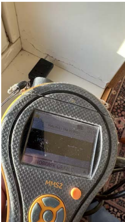
Registrert svelling i vindusforing kjøkken
