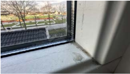
Delaminering av glass på soverom.
