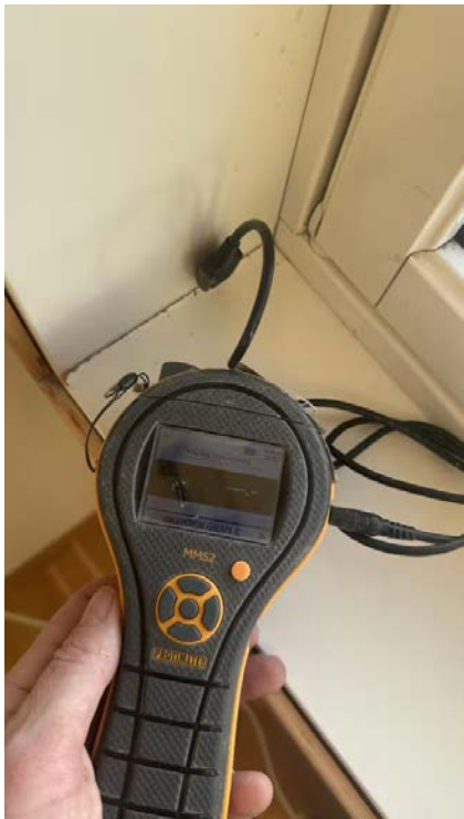
Registrert svelling i vindusforing kjøkken, ingen utslag på fukt.
